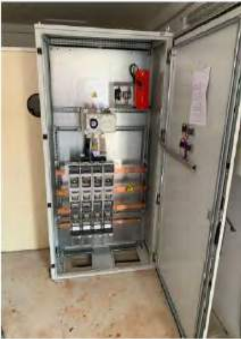
Figura 2.7.1.- Envolvente metálica del CGBT. (Fuente: Ibersun)
